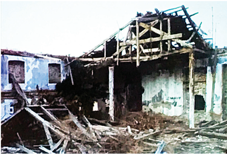
■ Η συναγωγή της Κομοτηνής με εμφανή τα σημάδια της εγκατάλειψης, λίγο πριν την οριστική κατάρρευση, με το μεγαλύτερο τμήμα της ξύλινης οροφής να βρίσκεται ήδη στο έδαφος και πάλι από την παρουσίαση του κ. Μεσσίνας
